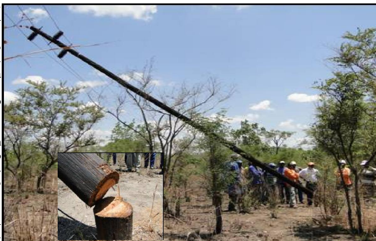
Também qualificado como “roubo ao desenvolvimento” por alguns cientistas sociais, o vandalismo de infra-estruturas eléctricas em Moçambique convida a uma reflexão profunda de todos os cidadãos (arquivo: P. Bacela)
